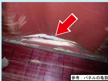
参考：パネルの亀裂
